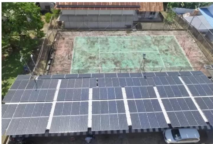
Gambar 4.3. PLTS Atap di Kantor Dinas ESDM Provinsi Jambi
